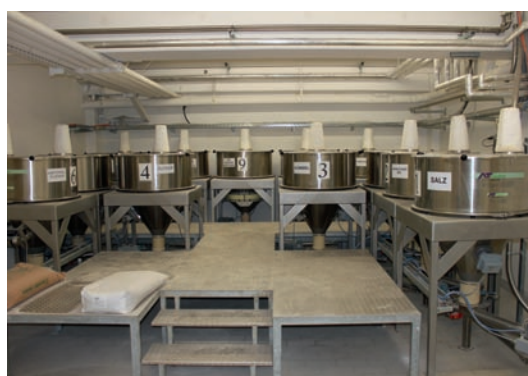
Übersichtlich und sauber: Zur einfacheren Beschickung der Tanks (nämlich von oben) dient das Edelstahlpodest.
